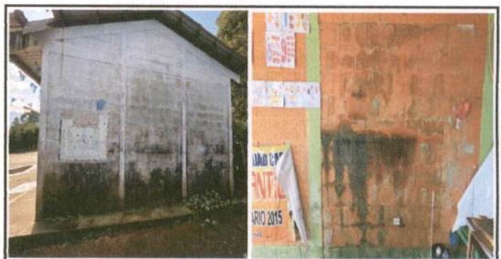
MÓDULO 1 AULAS PINTURA EN MUROS EXTERIORES E INTERIORES: Pintura en muros exteriores e interiores
